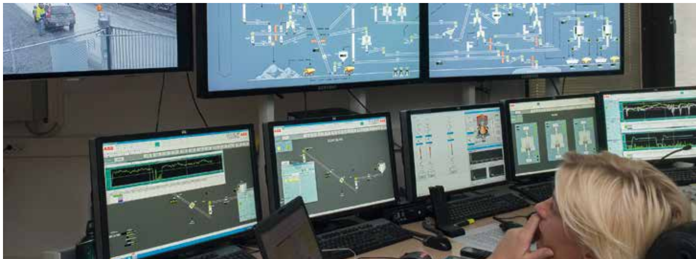
Produktionen i sovringsverket övervakas och styrs inifrån kontrollrummet som är inrymt i den renoverade kontorsbyggnaden.
