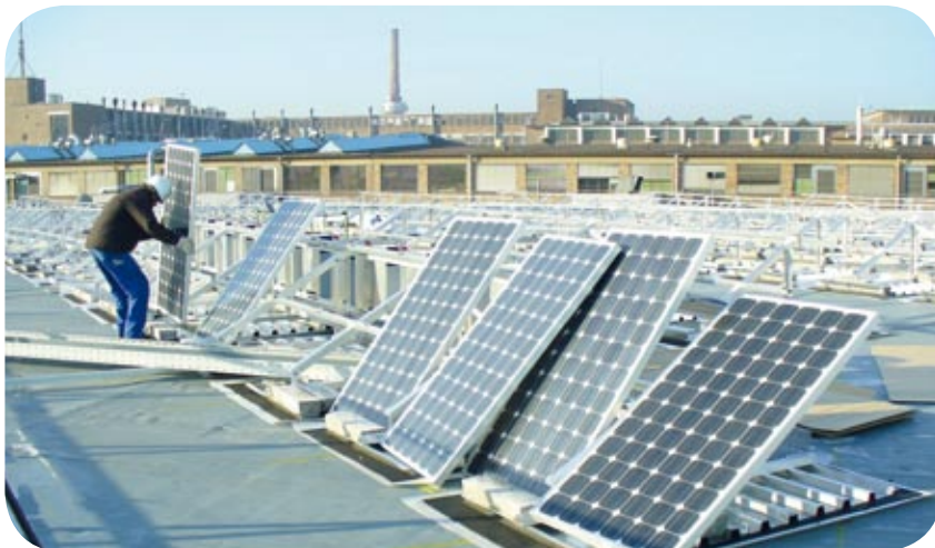
SKF Logistics Services Centre i Schweinfurt, Tyskland, investerade i ett omfattande solpanelsprojekt, som täcker centrrets 15 000 kvadratmeter stora tak.
