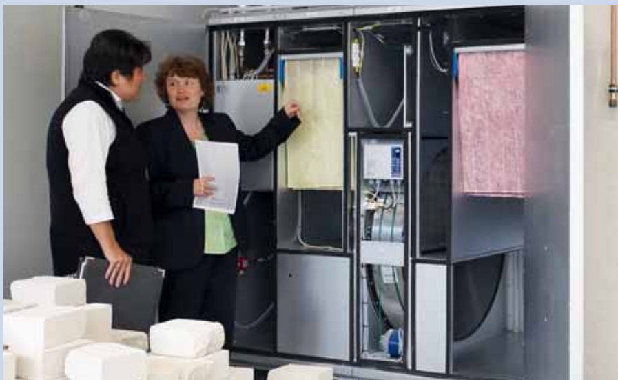
Sex Topvex energiåtervinningsaggregat är installerade i ett handikappcenter i Duisburg, Tyskland. På bilden syns Elke Herget, säljare för Systemair i Tyskland, med en representant för byggkonsultföretaget.
