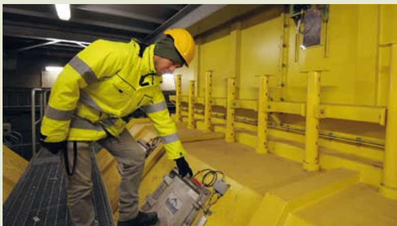
En del av materialhanteringsutrustningen vid Jordbro Kraftvärmeverk.
